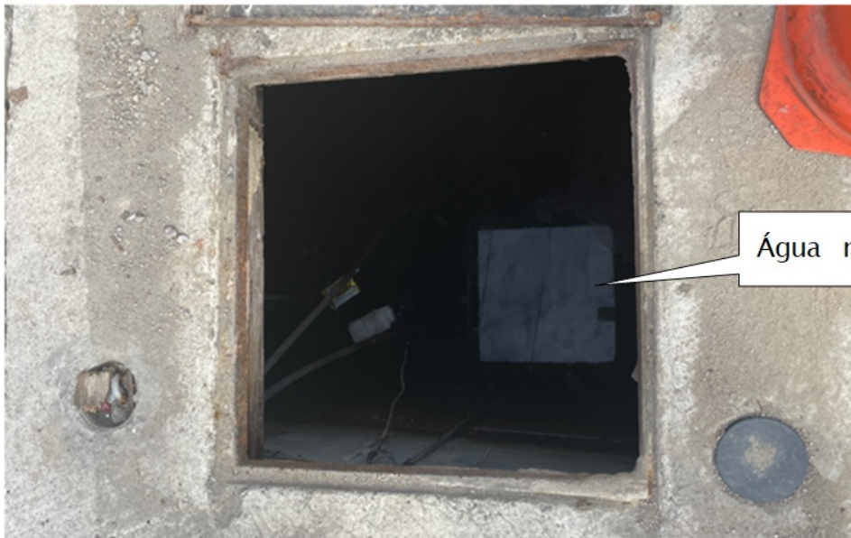
Foto 3 – Poço da bomba com água no interior e com baixa visualização
