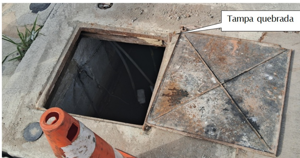
Foto 2 – Poço da bomba com a tampa quebrada
